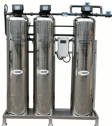
Estación de desmineralización
